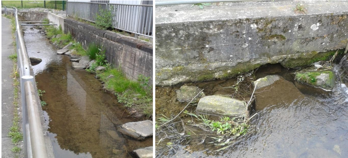
Abbildung 37: Verwitterter Uferbereich des Hambachs im Dorfbereich
